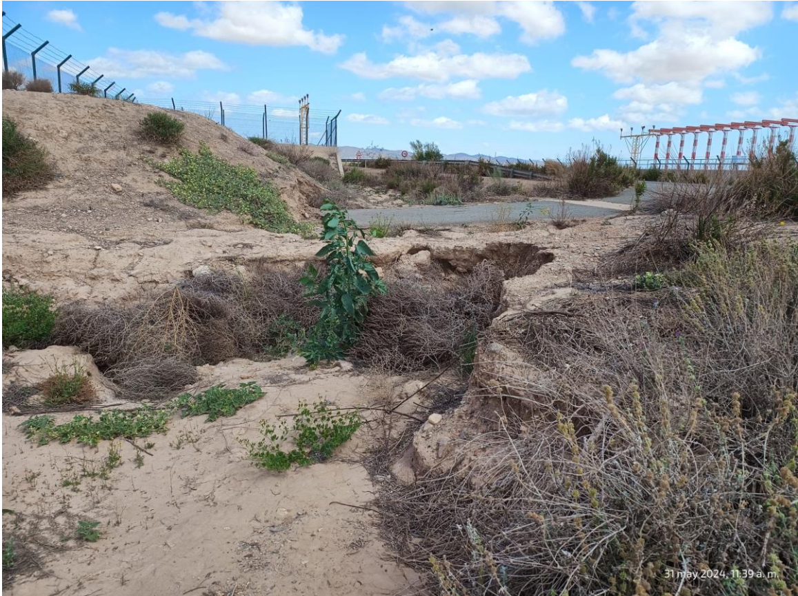
Foto 2.1.B.3. Detalle zona rehundida a reparar.
