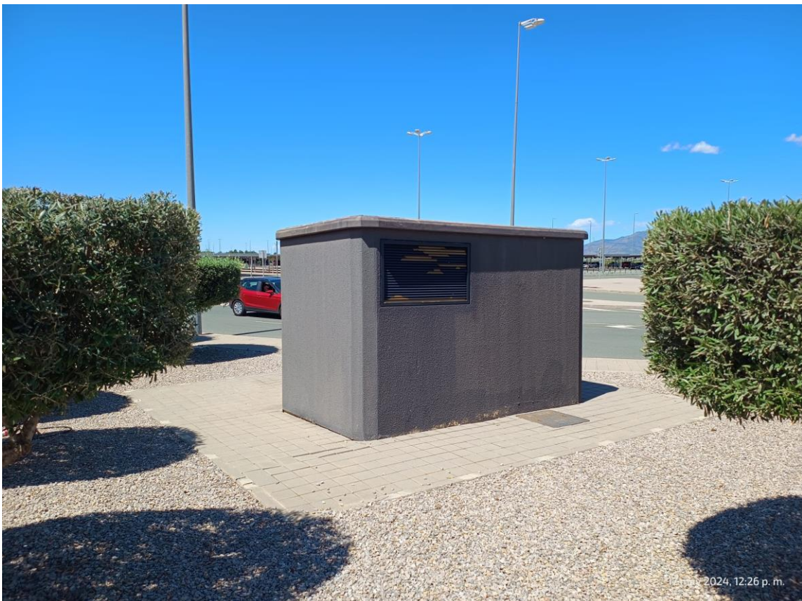
Foto 2.2.A.2. Caseta del CT a aproximadamente 16 metros de distancia.
