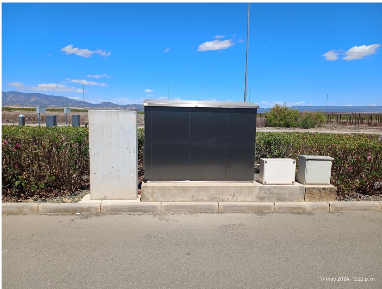
Foto 2.2.D.2. Detalle zona instalación nuevo cuadro de control.
