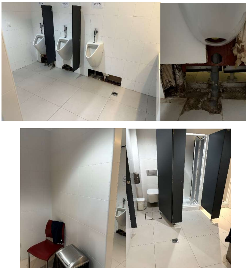
Imagen 7. Estado actual Aseo/Vestuario Masculino.
