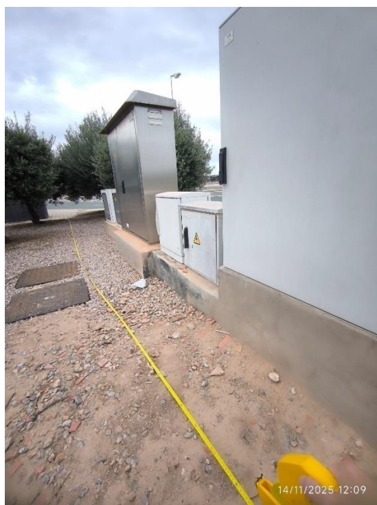
Foto I.2.C. Detalle medición distancia tramo cuadro de Metasys hasta arqueta anillo fibra junto al centro de transformación.
