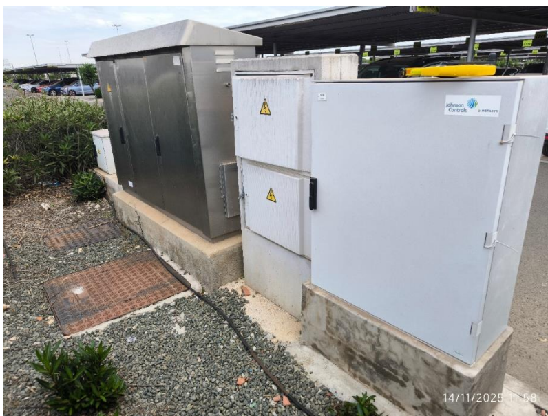
Foto I.1.B. Vista zona general donde está el cuadro de control de Metasys.
