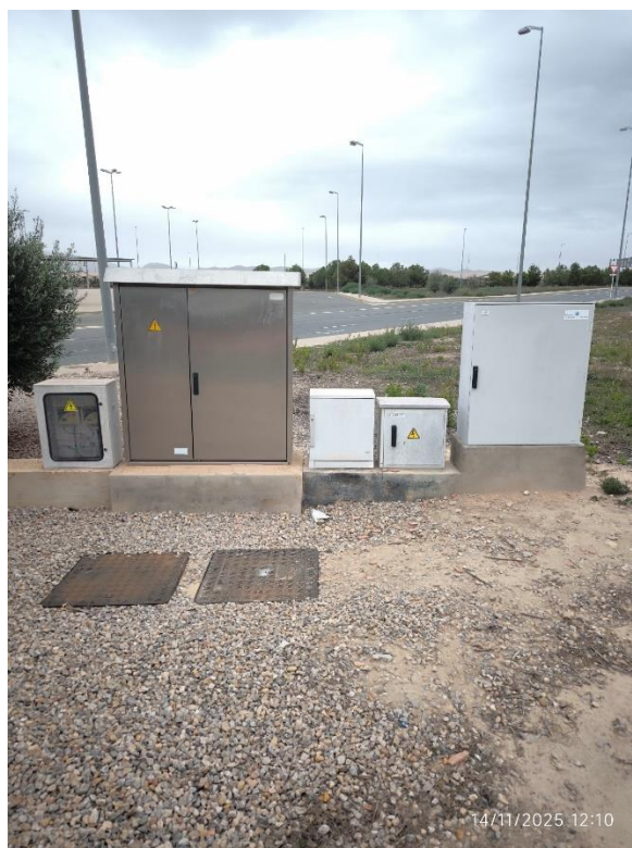
Foto I.2.B. Detalle de situación del cuadro de Metasys del parking de empleados.
