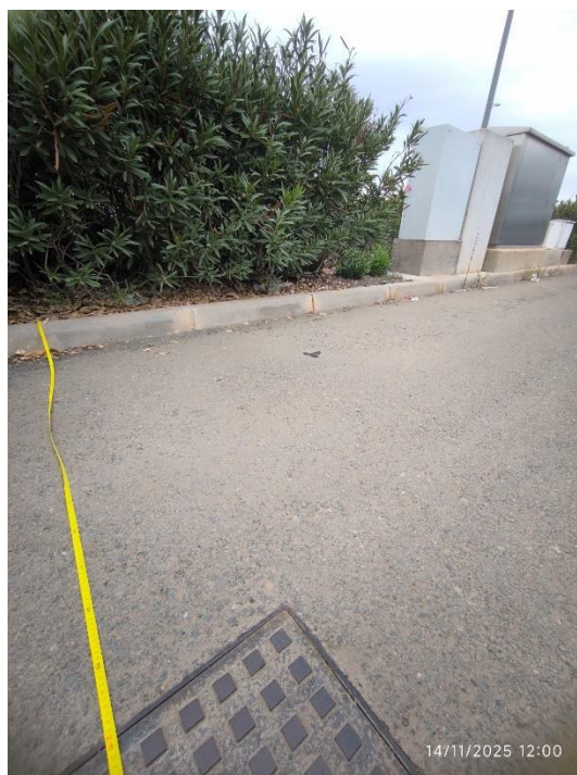
Foto I.1.C. Arqueta comunicaciones más próxima al cuadro de control de Metasys por donde pasa el anillo de fibra actual.
