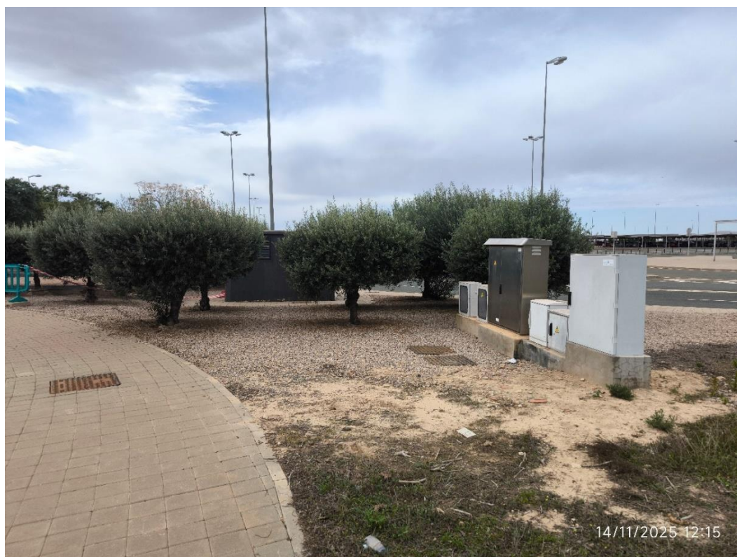
Foto I.2.A. Zona de situación del cuadro de Metasys.
