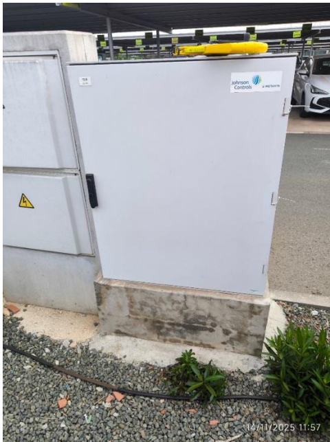
Foto I.1.A. Detalle del cuadro de Metasys instalado cerca de barreras de entrada y del centro de transformación. Origen del nuevo trazado de la fibra óptica a instalar.
